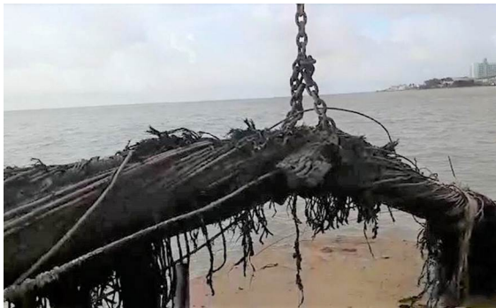
图2 海底电缆锚害损伤照片
