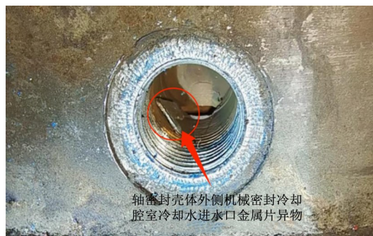
图 4 机械密封冷却腔室冷却水(闭式水)进口
