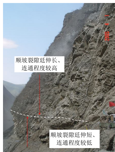
图 2 IV# 梁顺坡裂隙的垂直分带性
