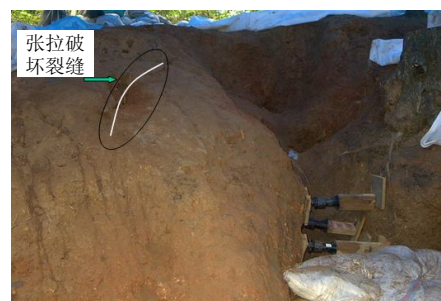
图4 Cave型断面部位现场张拉破坏裂缝
