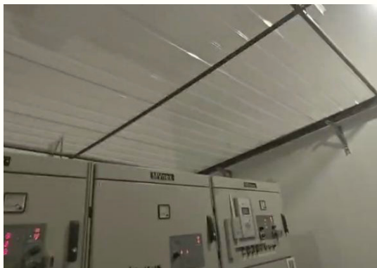
图6 地下站开关柜顶部防雨棚
