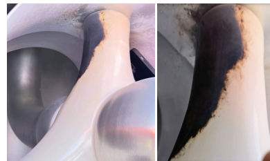
图 2 故障三支柱绝缘子烧蚀痕迹
