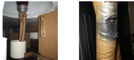
(a) 均压环从套管尾部脱落 (b) 中性点端部导线绝缘烧损
