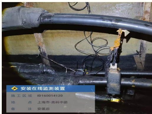
(a) 暂态地电压传感器安装图
