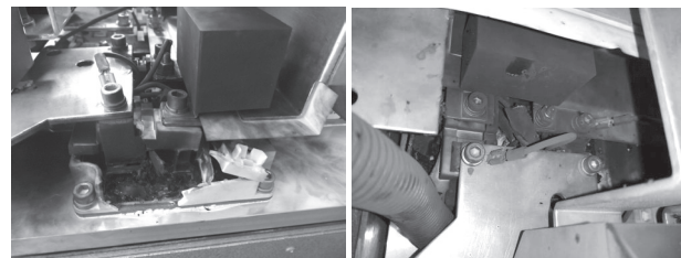
图 4 功率单元故障位置 1 图 5 功率单元故障位置 2
