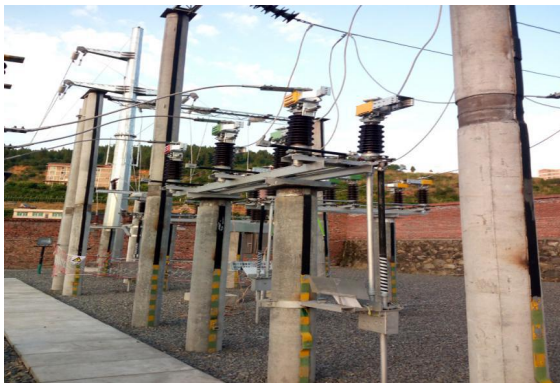
图 1 主网 35kV 变电站
