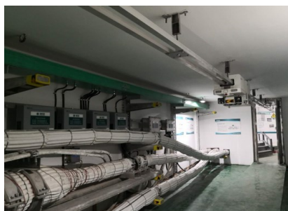
图 2 220kV 彭九线电力电缆隧道在线监测系统及轨道机器人
